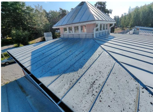
Peltikate on alkuperäinen. Peltikatteen muovipinnoitus vaikutti ehjältä ja hyväkuntoiselta.
