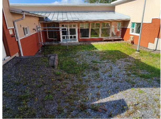
Rakennus sijaitsee rinteessä ja etupihan puolella maanpinnan sadevedet valuvat kohti rakennusta. Sadevesikaivoja on riittävästi, mutta maanpinnan muotoilut ovat paikoin puutteellisia.
