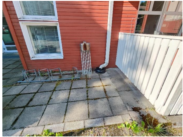
Pääsisäänkäynnin edustalla julkisivun lautaverhoilu on hyvin lähellä maanpintaa.
