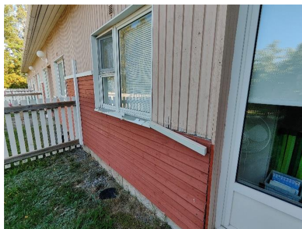
Lautaverhouksen kiinnitykset ovat paikoin pettäneet.
