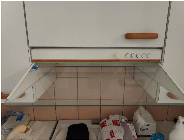
MUH-Liesikupu jossa poistoilmanvaihdon säätö
