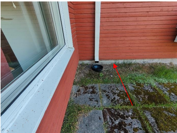
Lounaispuolella rakennuksen alkuperäisen osan sokkelissa patolevyä ei kuitenkaan havaittu lainkaan.
