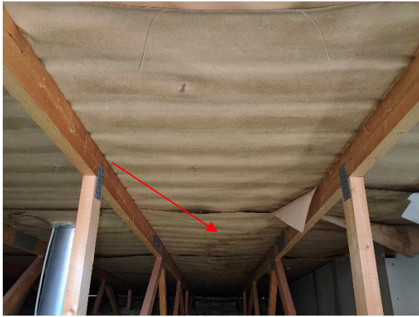
Aluskatteessa havaittiin muutamia vuotojälkiä ja kondenssiveden aiheuttamia jälkiä.
