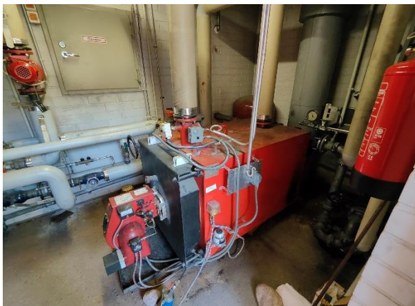
Alkuperäinen öljypoltin sekä kattila
