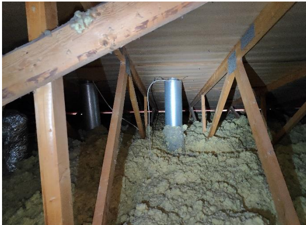
Eristetty ja pellitetty IV-kanava ullakolla.
