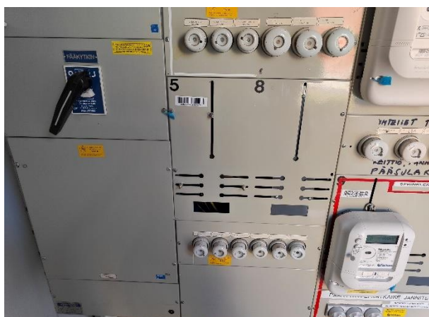
Pääkeskus ja kiinteistöosa.
