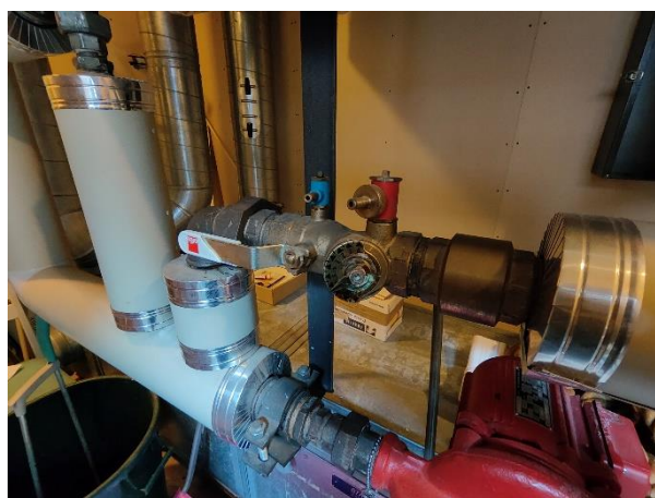
Ilmanvaihtokoneen linjasäätöventtiili vanha
