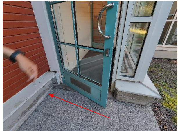
Laajennusosan etupihan puoleisen sisäänkäynnin edustalla sokkelissa on kosteusjälkiä sekä kalkkihärmää.
