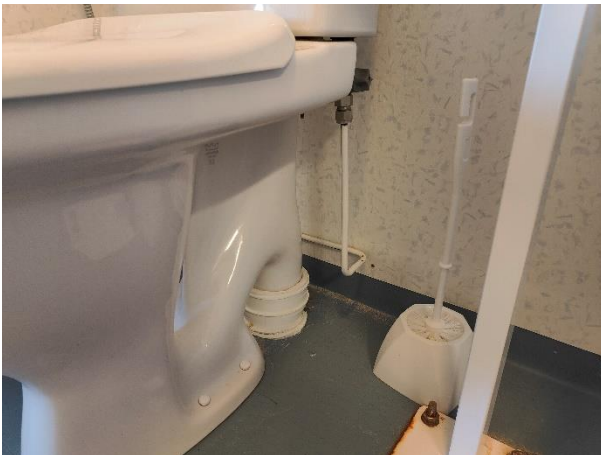
Kylpyhuoneen WC S-lukolla.
