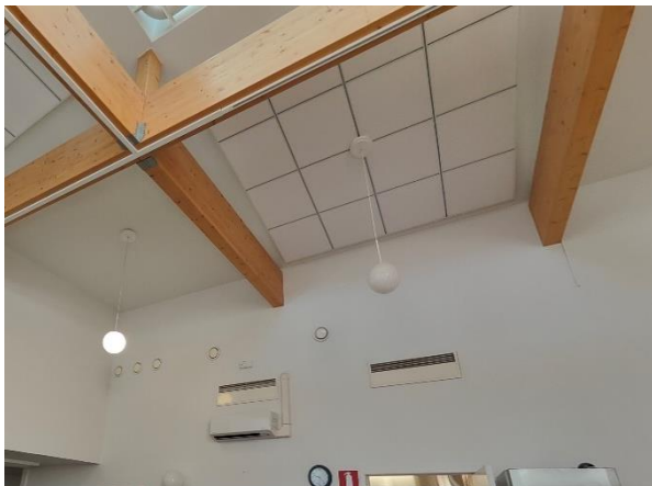
Tulo- ja poistoventtiileitä aulatilassa
