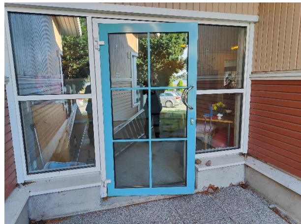
Metalliset pääovet ovat rakenteeltaan hyväkuntoisia ja niiden maalipinta on siisti ja ehjä.
