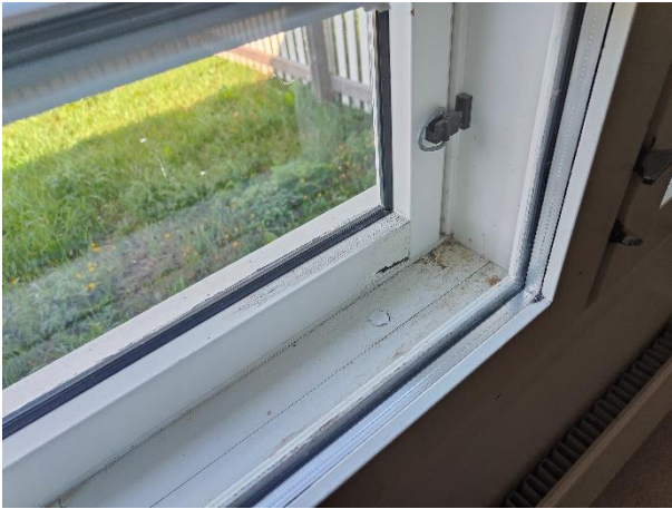
Ikkunoiden maalipinta hilseilee monin paikoin sekä sisä- että ulkopuolisissa puitteissa.
