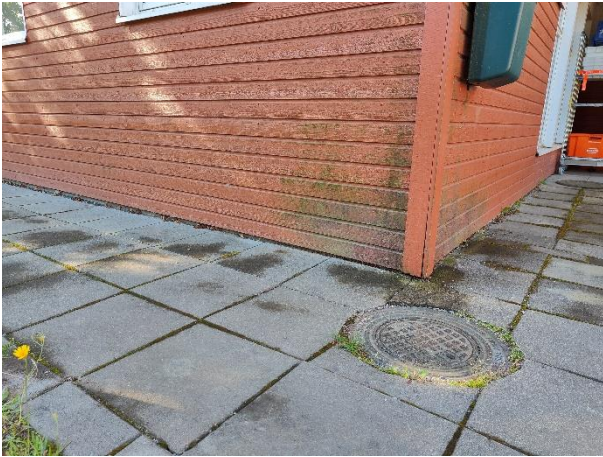
Pääsisäänkäynnin edustalla julkisivun lautaverhoilu on hyvin lähellä maanpintaa. Puupinnassa on kosteuden aiheuttamaa sammalkasvustoa ja tummumaa.
