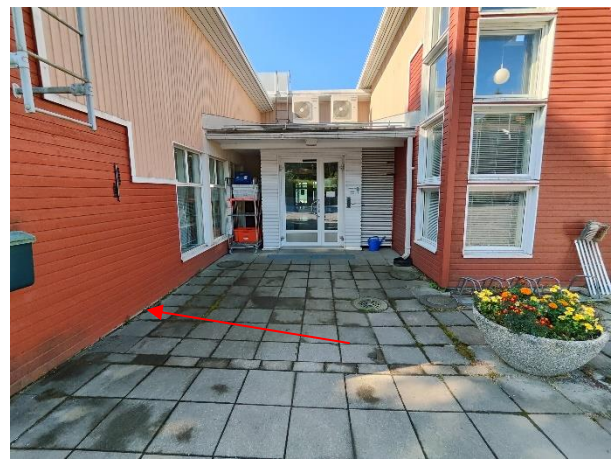
Rakennuksen pääsisäänkäynnin alueella sokkelikorkeus on hyvin matala. Suositeltu sokkelikorkeus on vähintään 300 mm.
