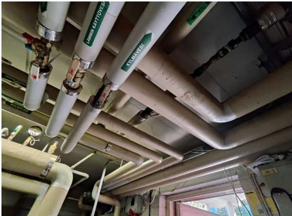
Käyttövesijohtot lämmönjakohuoneessa on eristetty asianmukaisesti.
