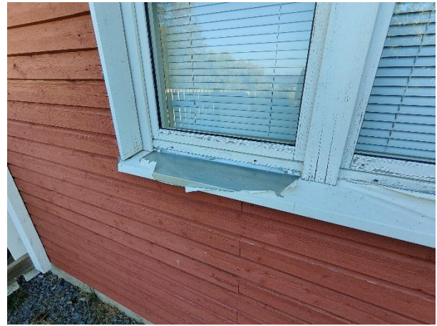
Ikkunoiden vesipeltien muovipinnoite on irronnut hyvin laajasti.
