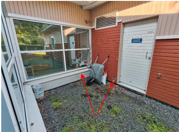
Laajennusosassa on niin kutsuttu valesokkelirakenne, joka luokitellaan riskirakenteeksi.
