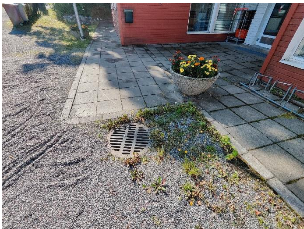
Rakennus sijaitsee rinteessä ja etupihan puolella maanpinnan sadevedet valuvat kohti rakennusta. Sadevesikaivoja on riittävästi, mutta maanpinnan muotoilut ovat paikoin puutteellisia.
